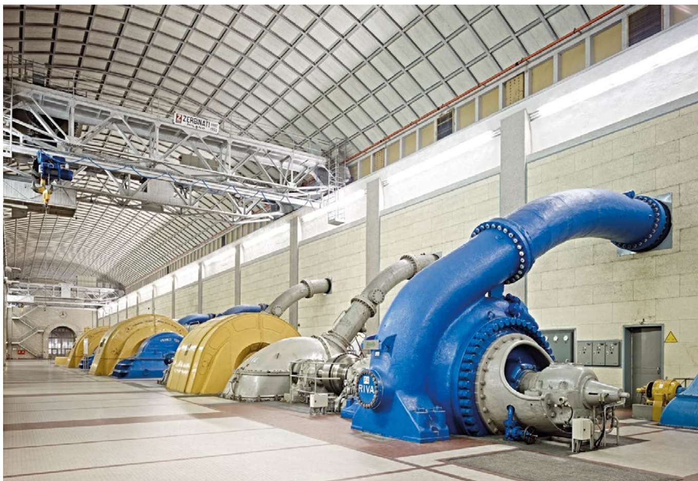
Interni della centrale di Santa Massenza
