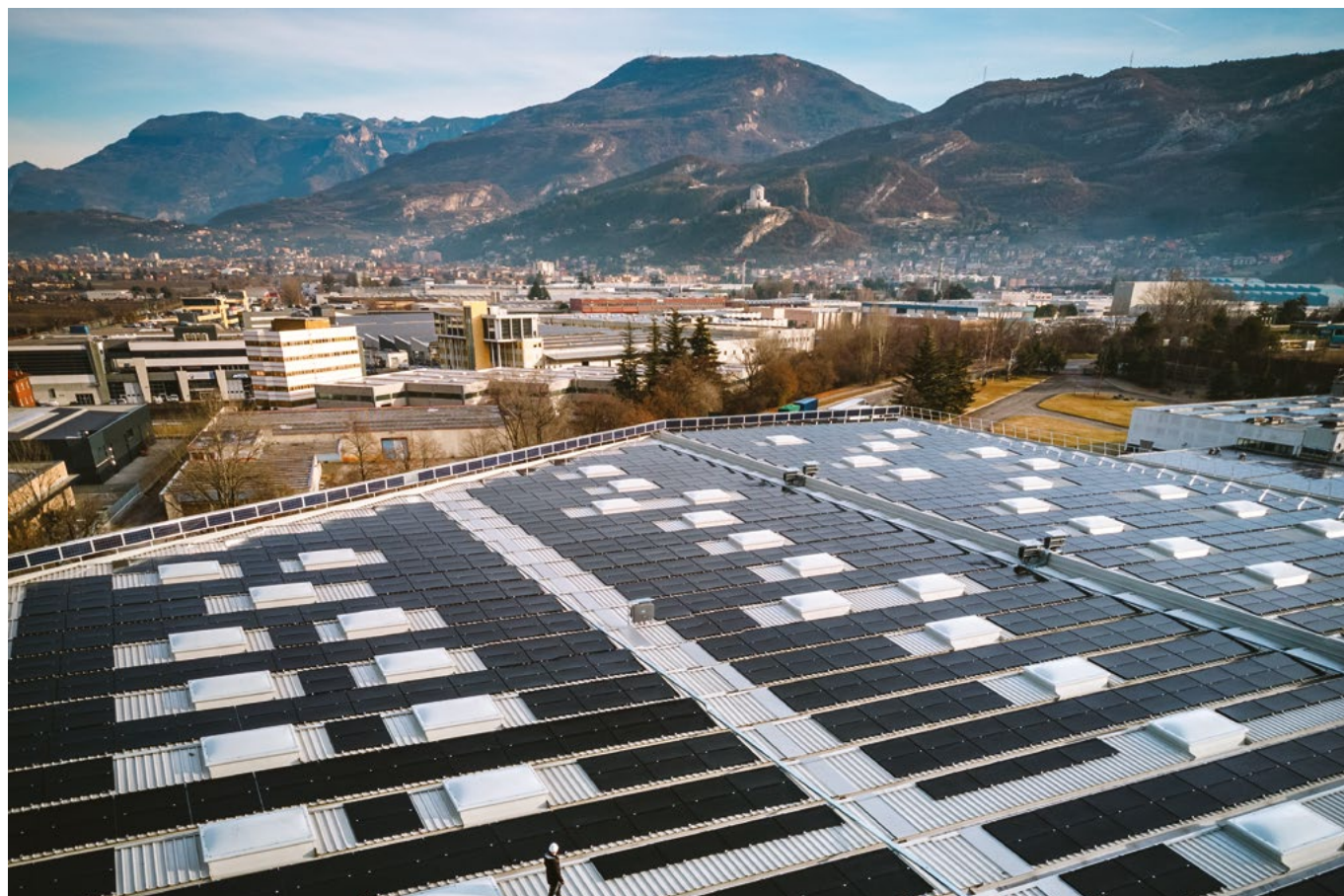
Impianto fotovoltaico a Rovereto
