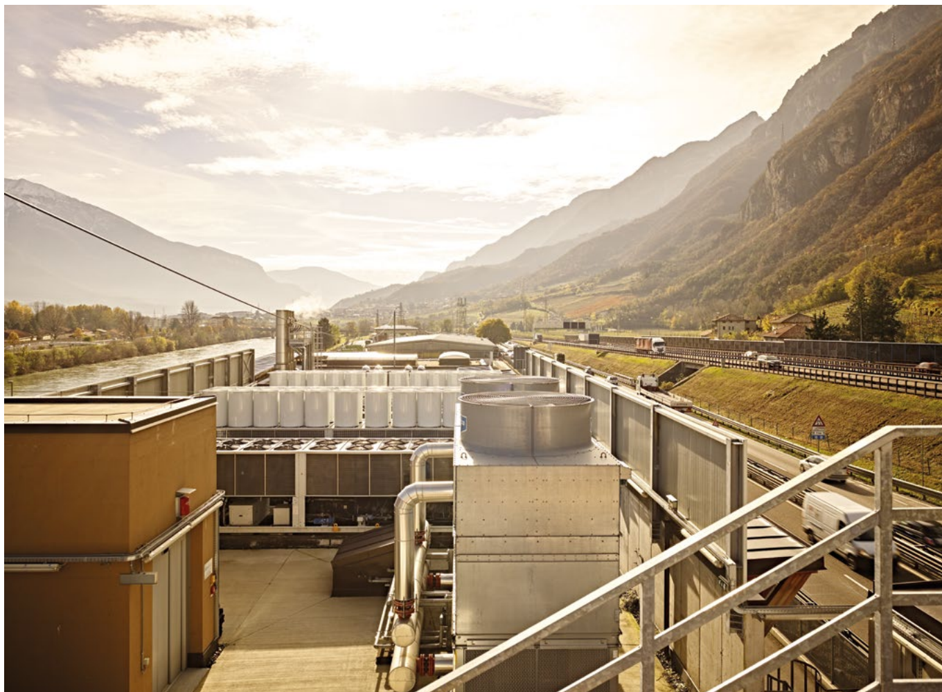
Centrale di trigenerazione
