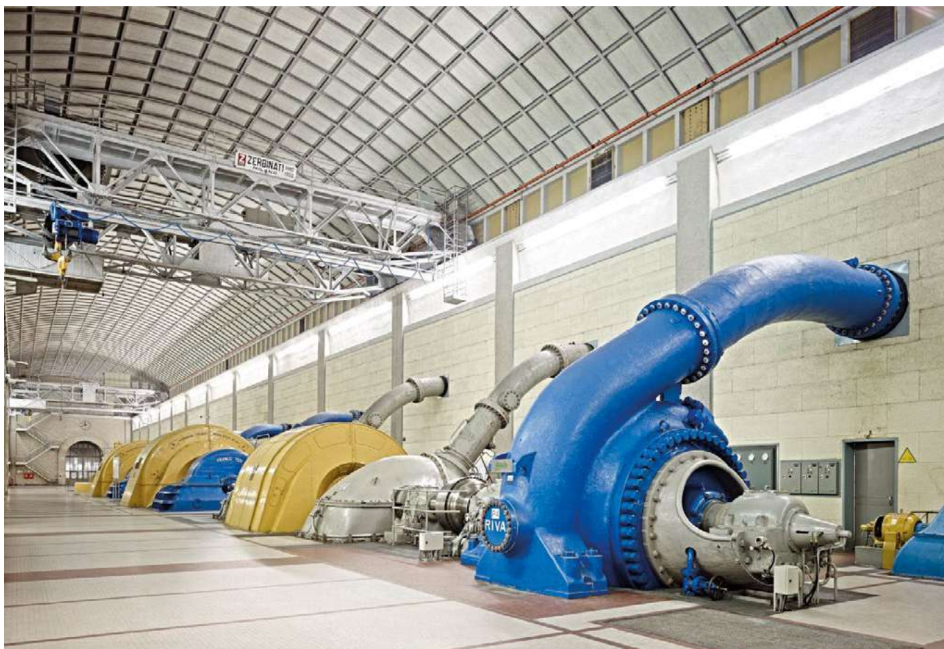
Interni della centrale di Santa Massenza
