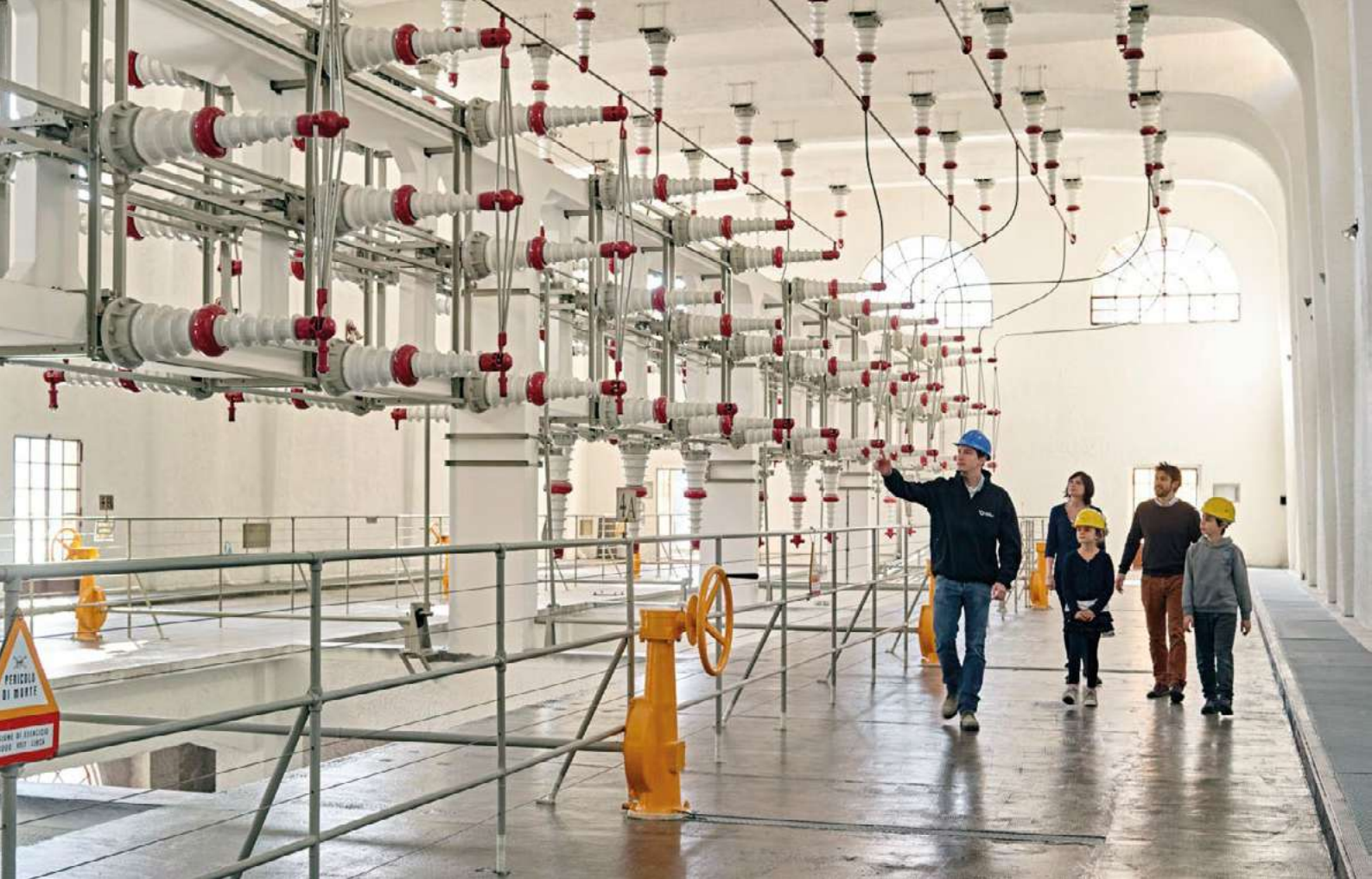
La centrale idroelettrica di Riva del Garda
