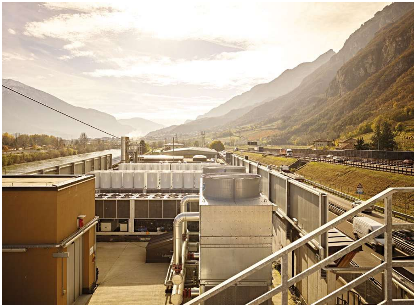
Centrale di trigenerazione
